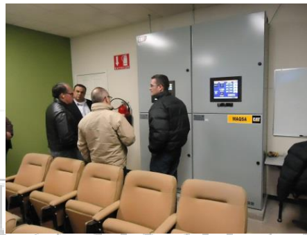
Imagen 8: Personal de Sindicatura en sala de control de generación de energía de BIOGAS de Juárez.
