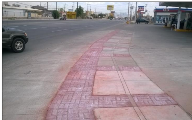
3. - JUNIO: Trabajos de imagen de Urbana: suministro de concreto para estampado de adoquín.
