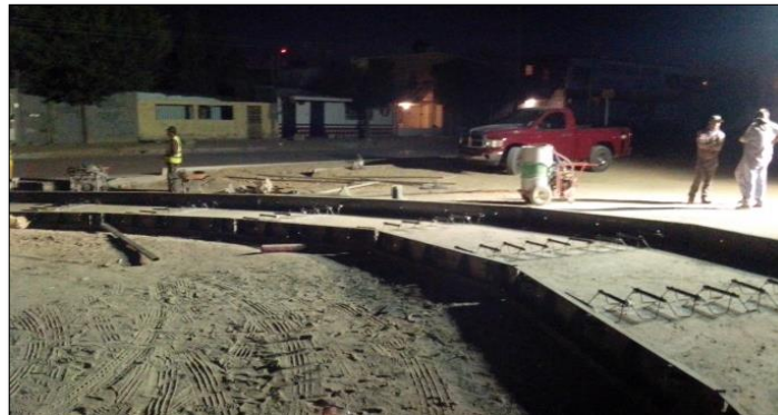
3. – JUNIO: Colocación de cimbra, se realizaron colados en horarios con menor intensidad de calor. También se realizaron trabajos de imagen urbana.
