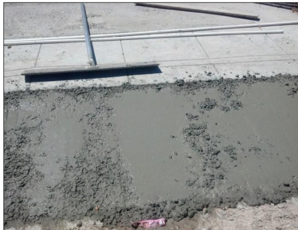
2. – MAYO: Trabajos correspondientes a imagen urbana: construcciones de guarniciones y firmes de espesor de 10 y 12 cms.
