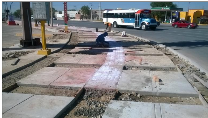
3. - JUNIO: Trabajos de imagen Urbana: construcción de firme de concreto y suministro de concreto estampado
