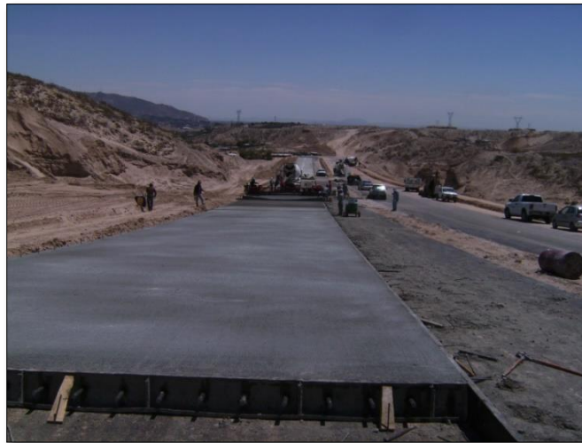
2. – MAYO: Construcción de losa de 28 cms de espesor en el cadenamiento 11+710 al 11+820.
