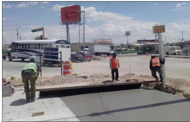
2. – MAYO: Construcción de losas de concreto de 28 cms de espesor. Empate con Blvd. Zaragoza, entre otros trabajos de imagen urbana.
