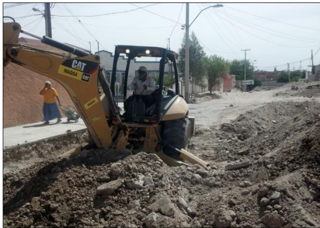
2. – MAYO: Se iniciaron los trabajos de corte de material, posteriormente suministro de subrasante y base.
