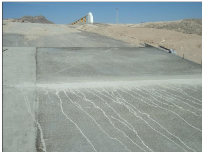
3. - JUNIO: se realizó el colado de losas de concreto en el cadenamiento 11+052 al 11+180.
