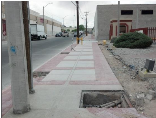
3. - JUNIO: Se han continuado con los trabajos de imagen urbana, esta es la condición actual de la vialidad
