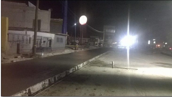
1. – OCTUBRE: Colado de losa de rodamiento en cruce de Av. Valentín Fuentes.
