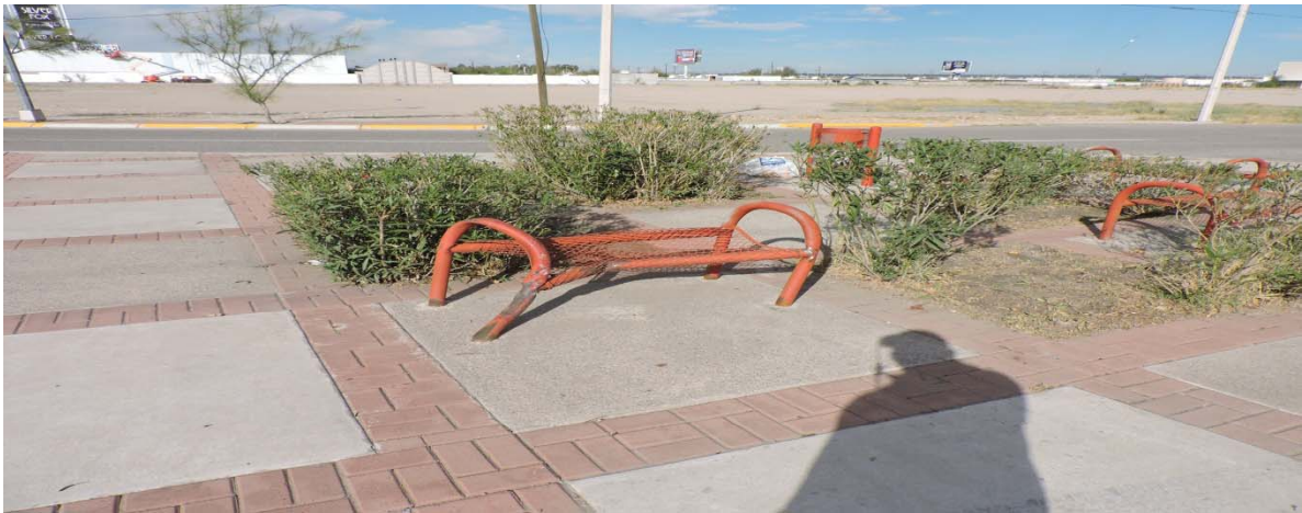
19. Monumento a los Trabajadores Le falta pintura a la base y placa. Daños en equipamiento (placas)
