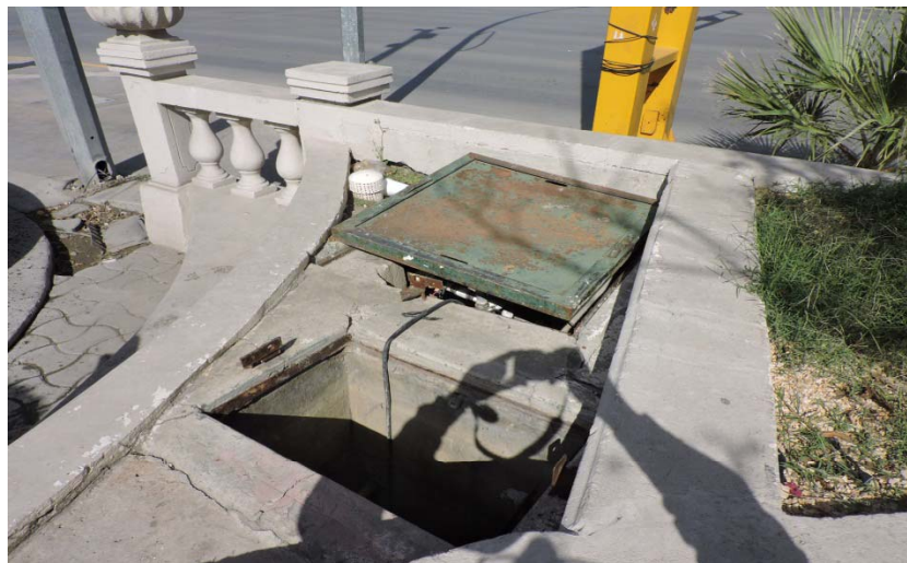
4. Fuente del Renacimiento Daños en fuente, riesgo para los transeúntes
